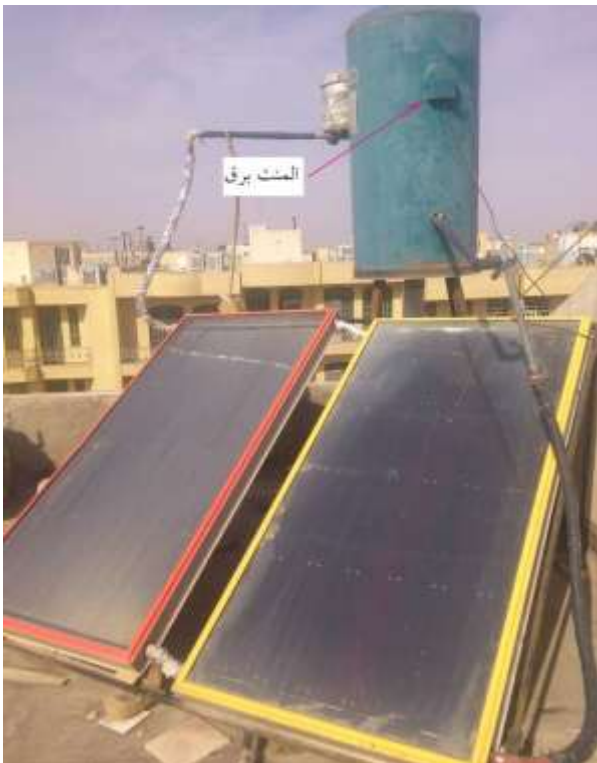
شکل (۱): تصویر آبگرمکن ترموسیفونی خورشیدی - برقی تحت مطالعه
